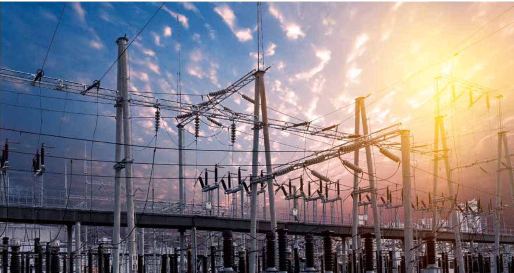
Herausforderungen für die Stromnetze von heute: die Energiewende.
